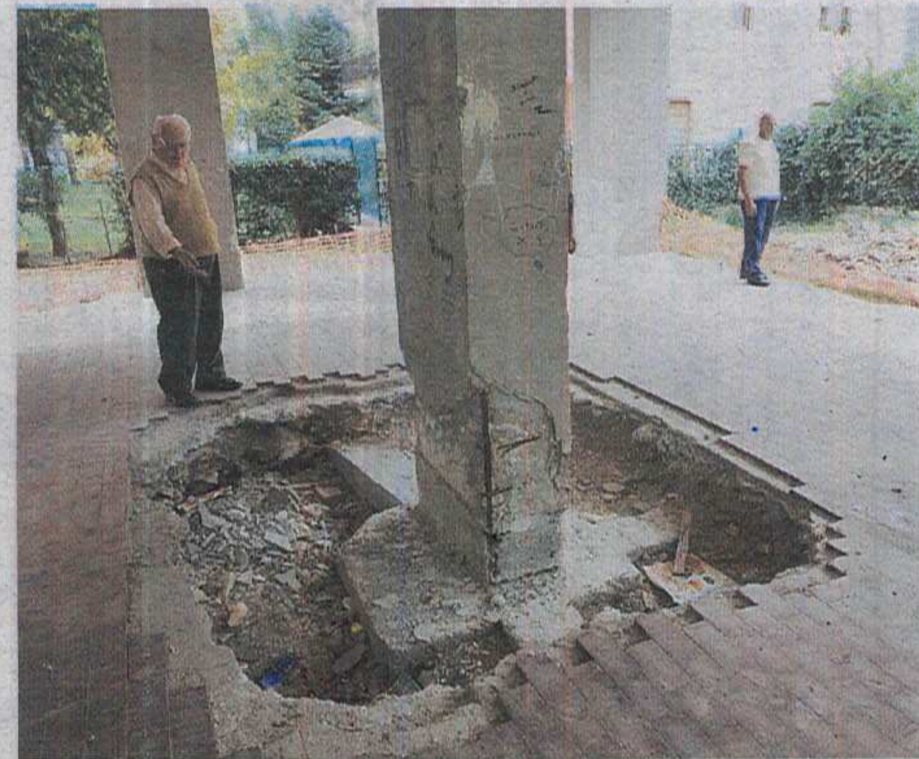
Un altro pilastro molto indebolito nella palazzina di via Amiterno
