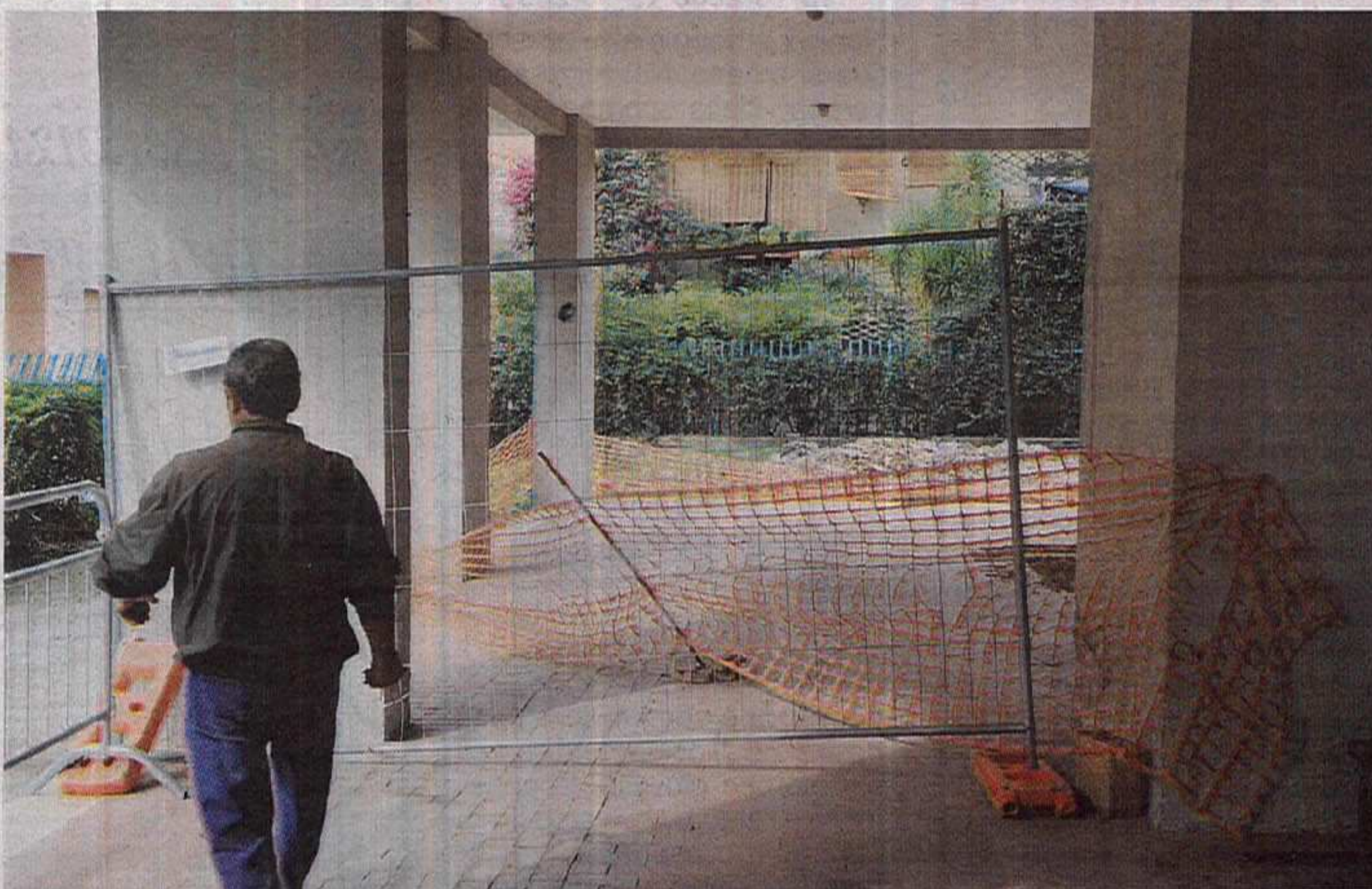
Uno dei tanti angoli pericolanti della palazzina numero 4 di via Amiterno
